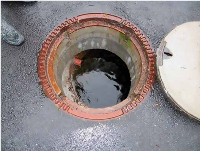
Zaplavená čerpací stanice splaškových odpadních vod
