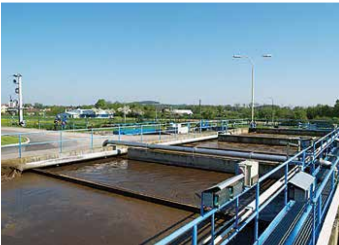
Obr. 10, 11. ČOV Vodňany vybudovaná v letech 1996–1997
