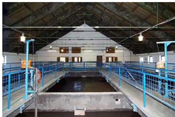
Obr. 8, 9. ČOV Černá v Pošumaví vybudovaná v roce 1993
