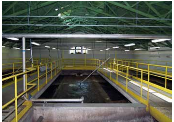
Obr. 12, 13. ČOV Frymburk vybudovaná v letech 1999–2000
