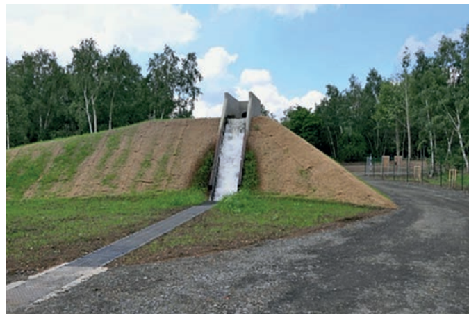
Obr. 2. Provzdušňovací (přívodní) objekt
