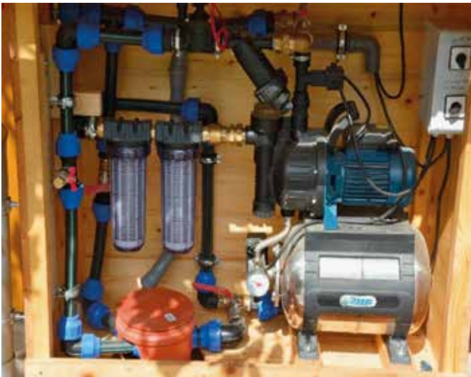
Obr. 11. Čerpací jednotka a tlakový filtr
