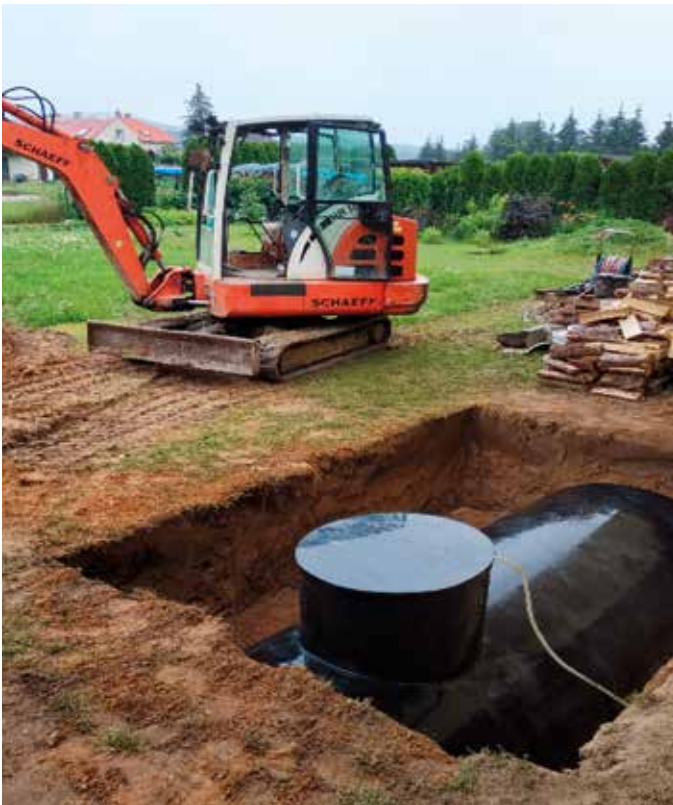
Obr. 4. Domovní akumuláční nádrž na srážkovou vodu
