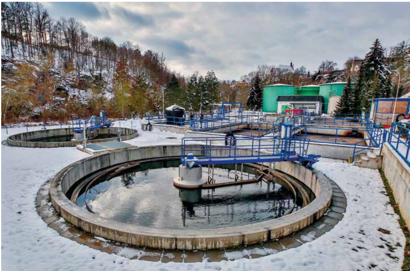
Obr. 2. Nádrže v ČOV v Bechyni
