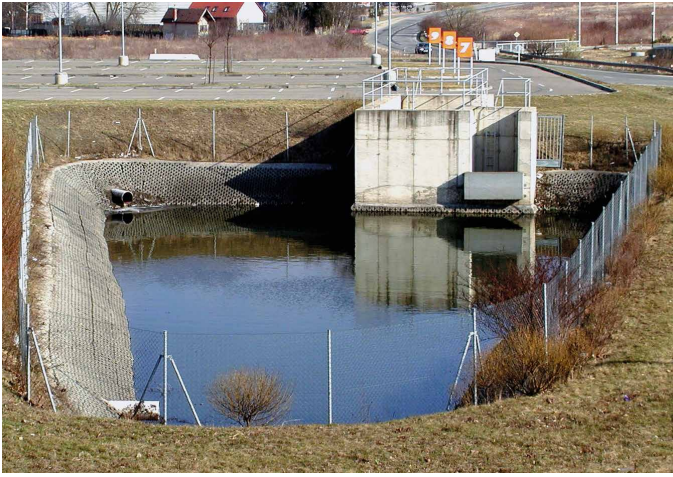
Obr. 13. Sedimentační nádrž s lapákem tuků a olejů v Brně-Ivanovicích
